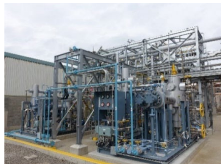
② CO 2 からメタノールを高効率に製造するパイロット設備
