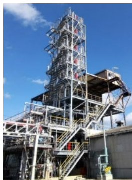
④ ケミカルリサイクル実証設備
