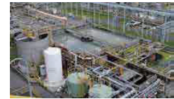
活性汚泥処理施設
