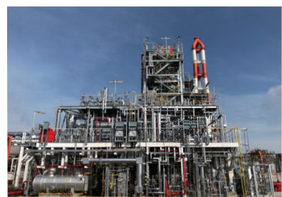
環境に配慮したエタノール由来のエチレン試験製造設備
