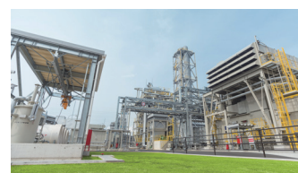
新居浜北火力発電所
